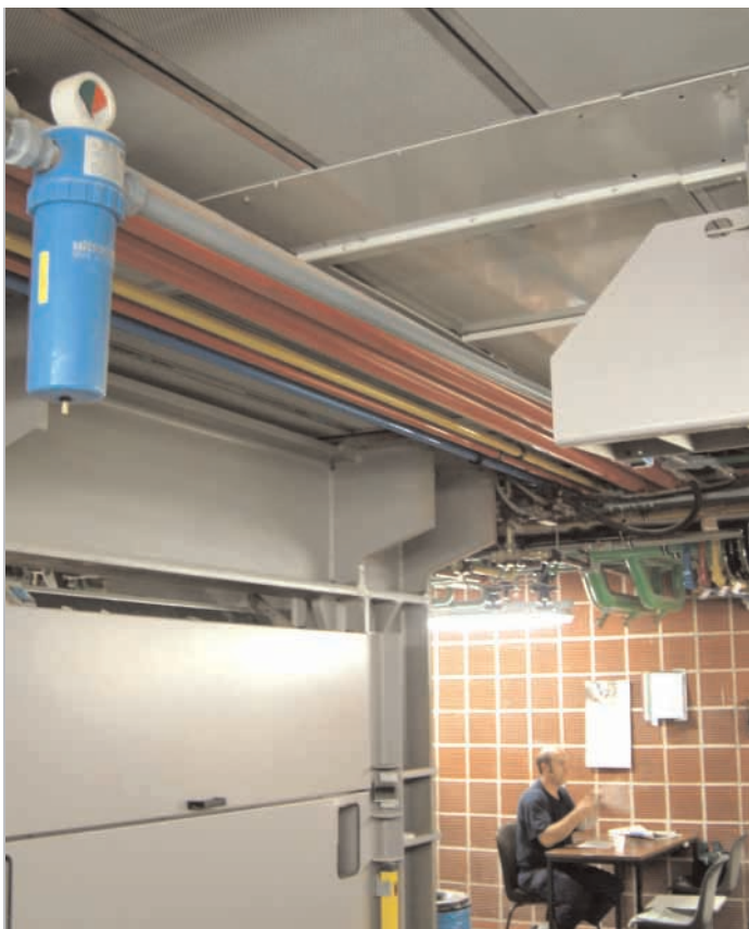
Im Untergeschoss der Offsetdruckerei Ahrensburg: Oben im Bild sichtbar die Schallschutz-Verkleidungen von Faist.
