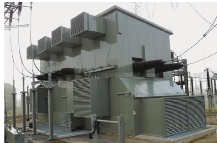
Звукоизоляционный блок трансформатора; проект E.ON, Германия
