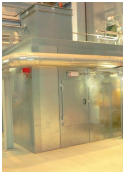
Внутренний звукоизолирующий блок для системы подачи топлива газовой турбины Siemens AG; проект Ливорно, Италия.
