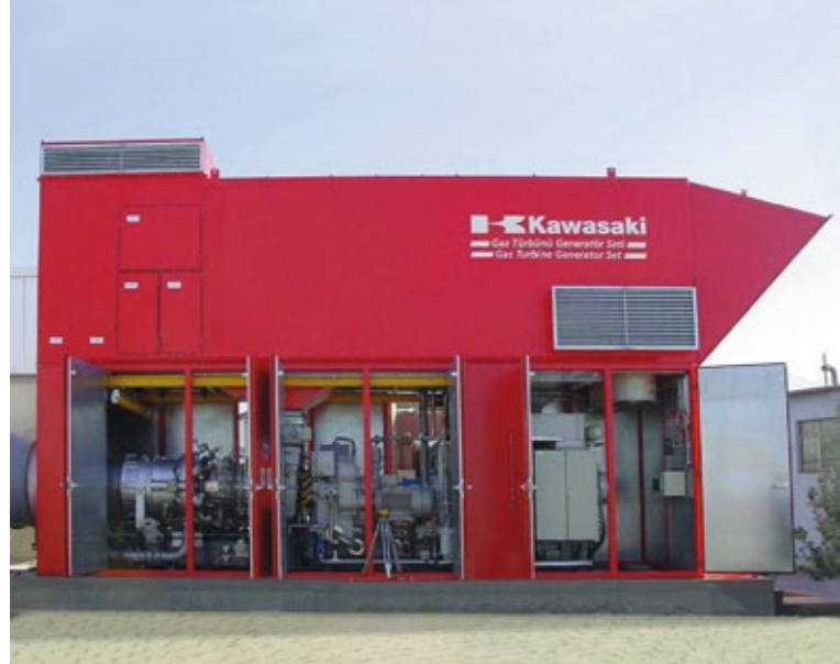
Звукоизоляционный блок для газовой турбины GBP70, KAWASAKI Gas Turbine Europe
