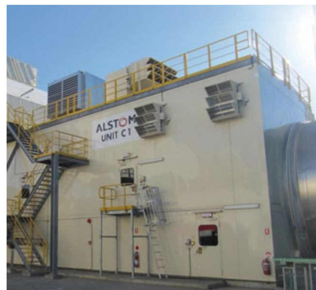
Звукоизоляционный блок для газовой турбины GT 13 Alstom AG; проект Колонгра, Австралия
