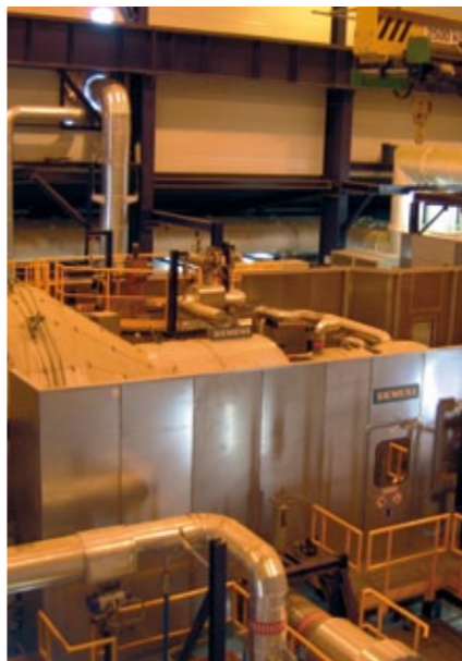
Звукоизолирующие стены паровой турбины Siemens AG, проект Сагунто, Испания
