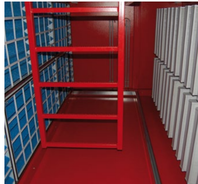
Вид фильтрационного отделения газотурбинного генератора GPB80 KAWASAKI Gas Turbine Europe
